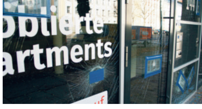
Das beschädigte Wohnheim
